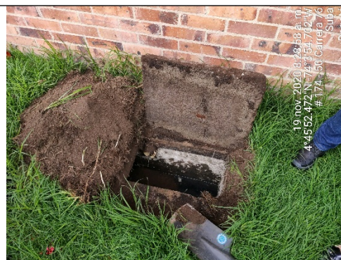
Foto No. 2. Sistema de trampa de grasas casa No. 2
